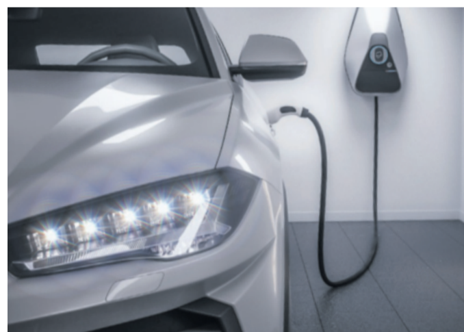
Eine Stromtankstelle kann man nicht „einfach so“ installieren – hier muss der Fachmann ran. Fotos: Adobe.Stock.com
