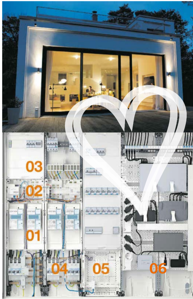
Moderne, digitale Technikzentrale mit Struktur: 01 Zählerfeld, 02 Raum für Zusatzanwendungen, 03 Anlagenseitiger Anschlussraum, 04 Netzseitiger Anschlussraum, 05 Abschlusspunkt Zählerplatz, 06 Multimediafeld
